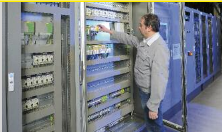
Schaltschränke mit transparenten Fronten geben Einblick auf die Phoenix Steuerungs-Komponenten.
