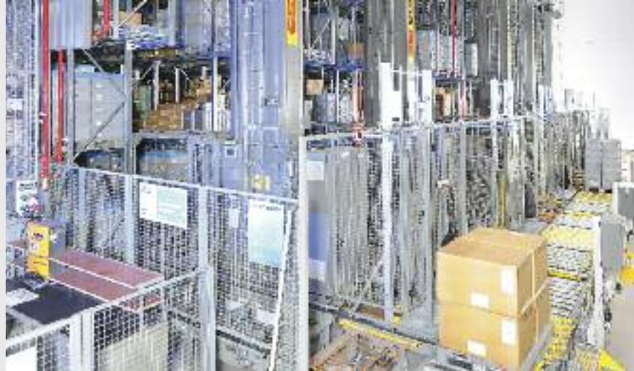
Die Nachschub- und Magazinpaletten werden am Übergabepunkt für die Einlagerung ins HRL bereitgestellt.
