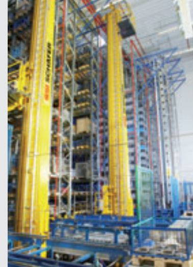
Gassenübersicht mit RBG und Fördertechnik
