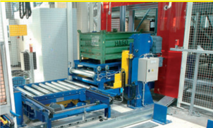
Heber Fördertechnik zur Lagerung ins HRL
