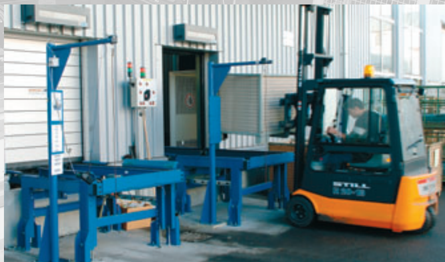
Verladezone mit Aufgabestation Außenbereich
