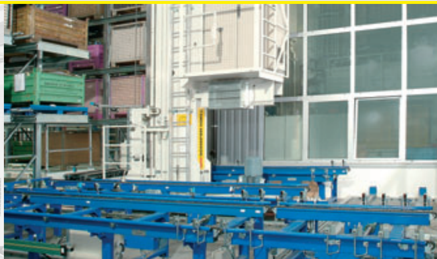
Hochregallager-Vorzone mit Palettenfördertechnik
