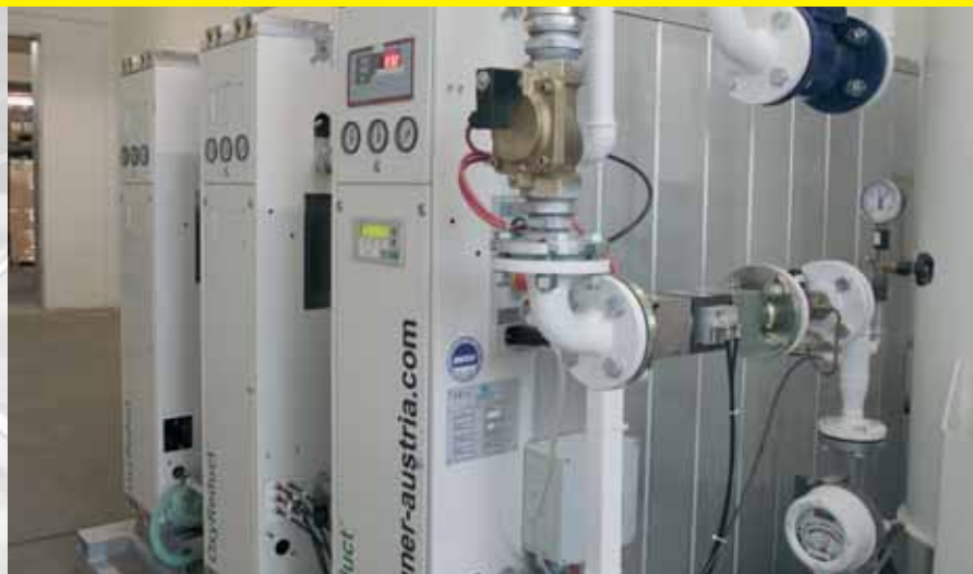
Brandschutz durch Oxy Reduct Anlage
