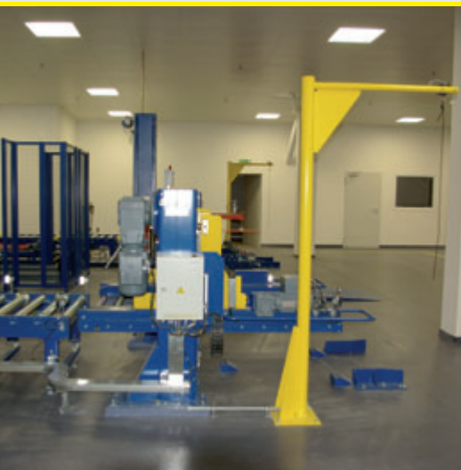
Bodenebene Aufgabestationen mit Konturenkontrolle
