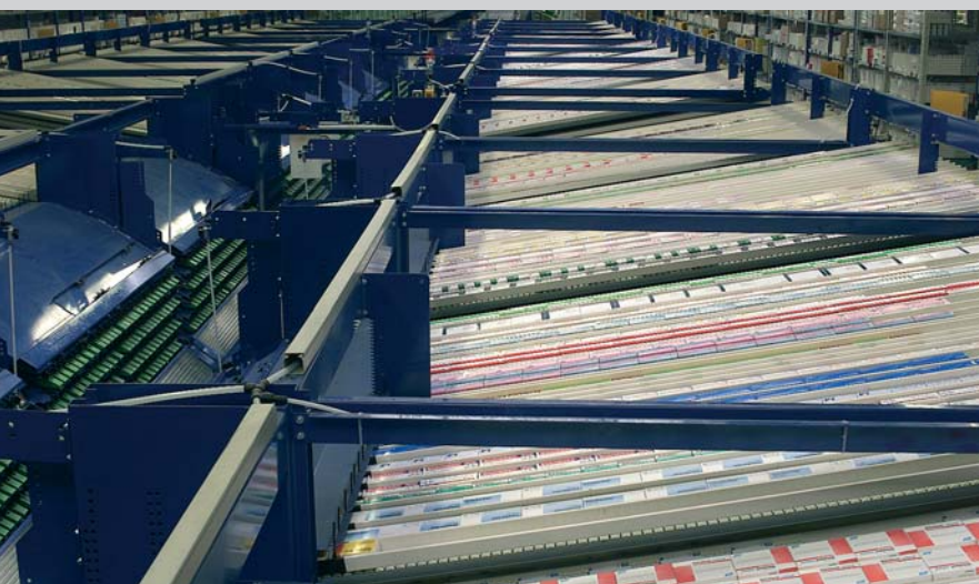
Kommissionierautomat K-Pemat kombiniert mit L-Pemat und S-Pemat mit 9.000 Kanälen
