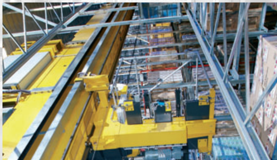
Elf Regalbediengeräte mit Teleskopgabeln zur doppelt tiefen Lagerung „arbeiten“ im Hochregallager
