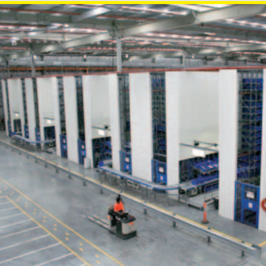
Automatisches Kleinteilelager (AKL)
