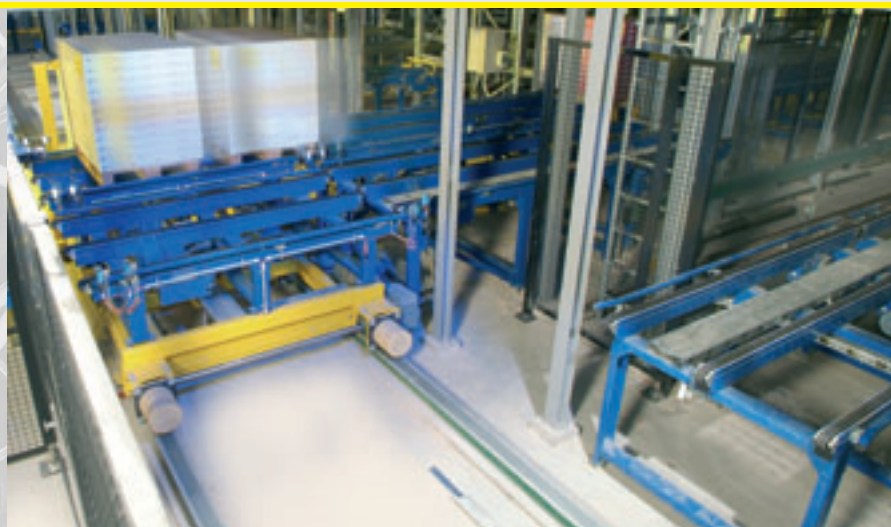
Ein für den Transport von insgesamt 4 Paletten geeigneter Doppelverschiebewagen sichert eine hohe Performance für parallele Ein- und Auslagerprozesse
