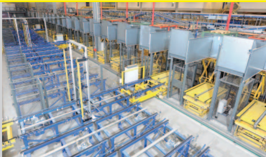
Über Verschiebewagen sind die Hubtische unter der Kommissionierbühne mit der Kettenfördertechnik verbunden
