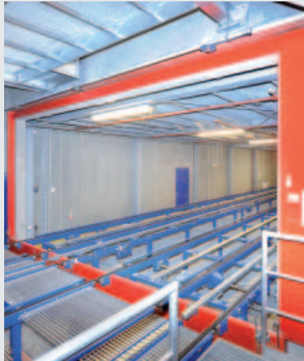
Brandschutztore riegeln im Ernstfall die Förderstrecken zum HRL ab.
